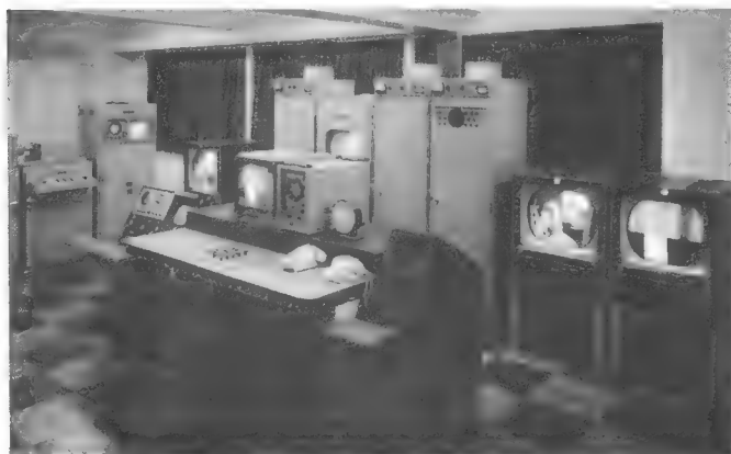
Bild 4. Blick auf Kontrolltisch und Bedienungspulte, Coder- und Testgeneratorschrank sowie Farbmonitore im Zentralgeräteraum
